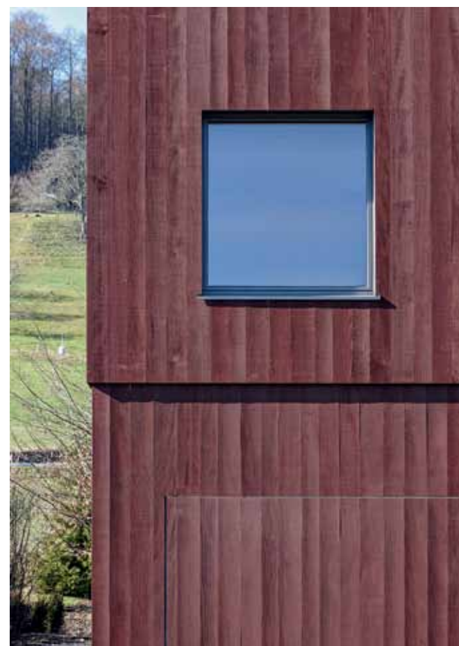
Gut altern: Leinölfarbe schützt das Holz vor UV-Strahlung. Das unregelmässige Aussehen der Fassade ist Teil der Schönheit dieses Baus.
