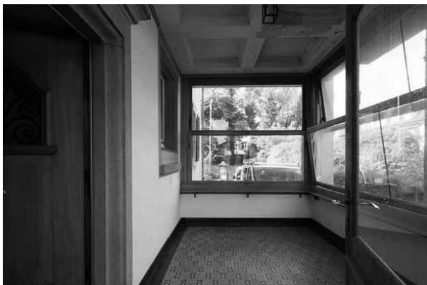
Vor dem Umbau diente der Eingangsbereich zwei Parteien als Zugang zum Haus.
